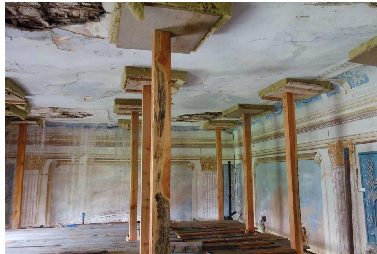
Obr. 1 Zámek Rychnov nad Kněžnou, objekt sala terreny. Pohled na vzpěrami vzepřený strop poškozené stavby před obnovou, s patrnou destrukcí stropu i silně poškozenou nejmladší neoklasiciistní výmalbu. [TŠ, 2017]
