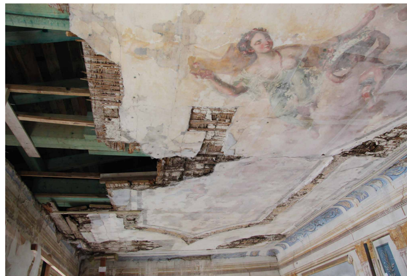
Obr. 2 Zámek Rychnov nad Kněžnou, objekt sala terreny. Strop ve fázi po odkrytu na rokokovou malbu a provedeném ochranném přelepu, s patrným rozsahem havárie stropu. [RŠ, 2018]
