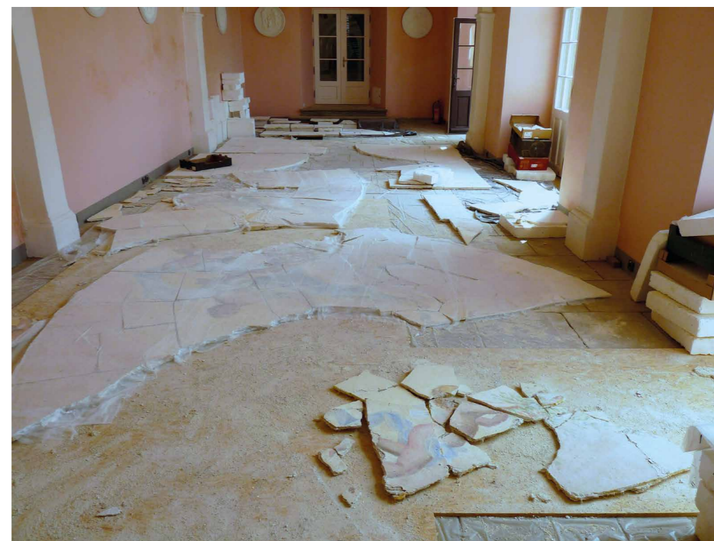
Obr. 7 Zámek Rychnov nad Kněžnou. Pohled na podruhé transferované snesené omítky stropu sala terreny, včetně sběru havarovaných částí. Zobrazen je stav v průběhu zajišťovacích a kompletačních restaurátorských úkonů omítkových dílů dočasně pracovní deponovaných v objektu lázně. [PL, 2022]
