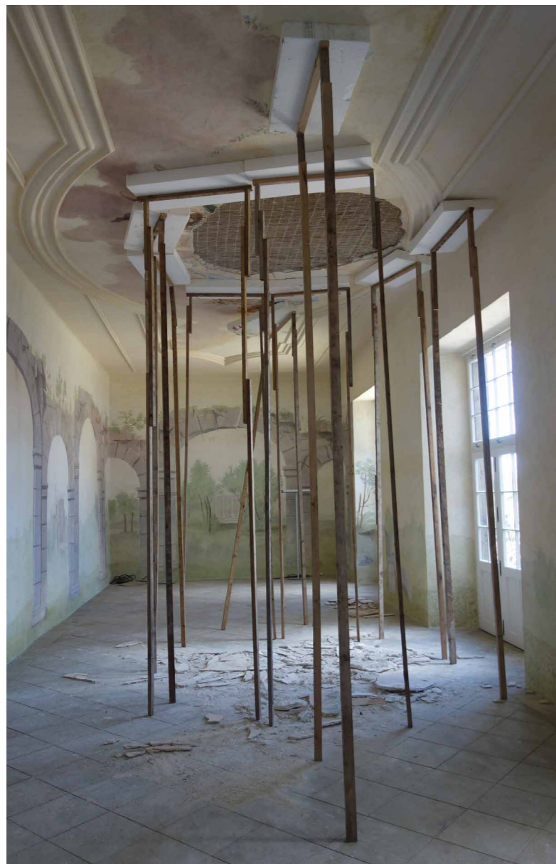
Obr. 5 Zámek Rychnov nad Kněžnou, objekt sala terreny. Pohled do prostoru po havárii části stropu. [TŠ, 2020]
