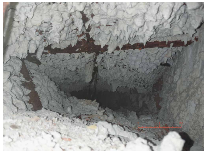
Obr. 12 Pohled do vnitřního prostoru korunní římsy v tamburu, patrné jsou korodující prvky nosné armatury, zajímavé jsou rovněž struktury vytvářené protečením tuhnoucí sádry skrze armovací pletivo. [DCH]
