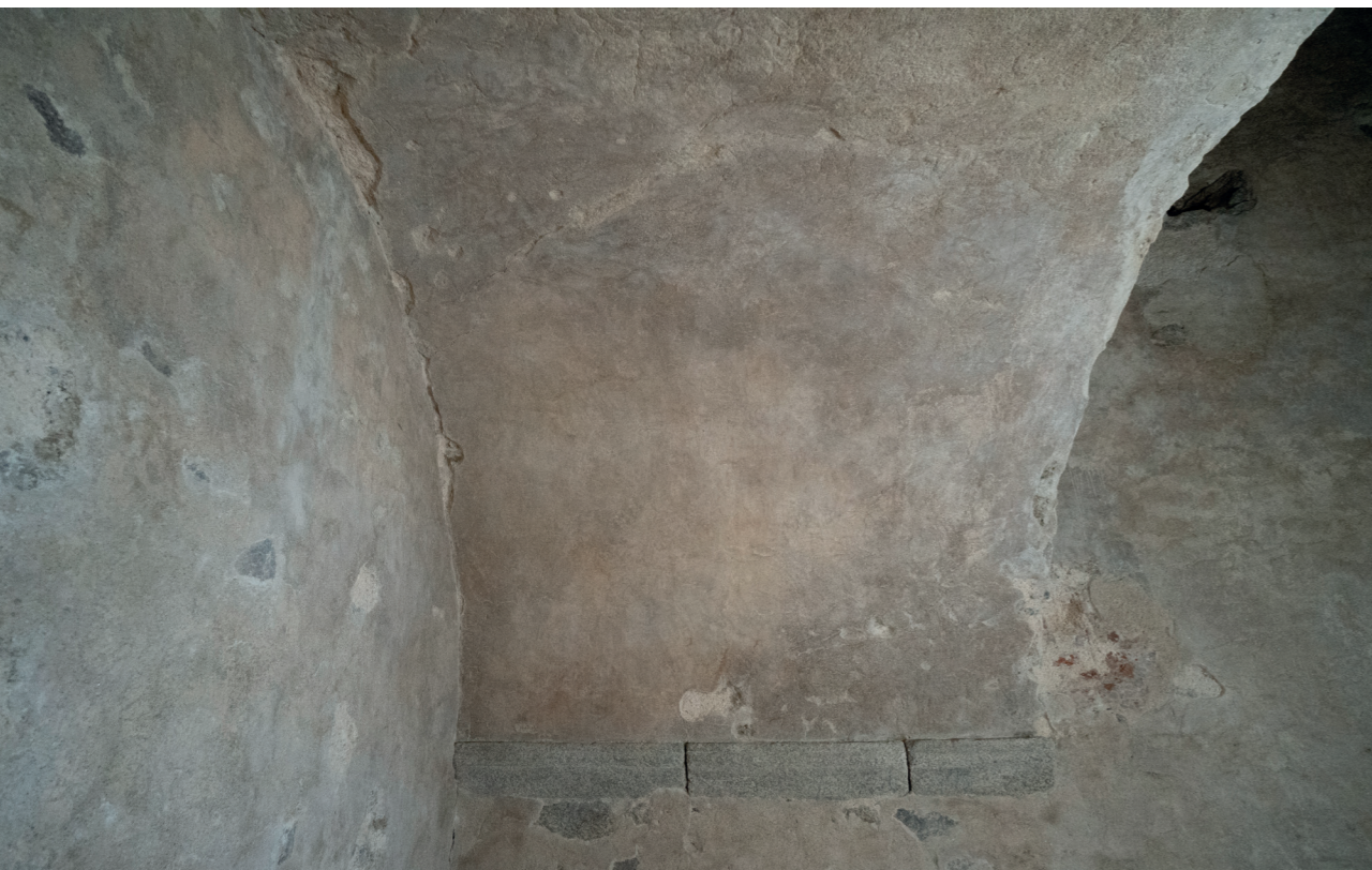
Obr. 2 a 3 Výkvěty solí na klenbě pod emporou v roce 2017 a stav omítek na témže místě po odsolování v roce 2022. Foto: Jana Waissarová
